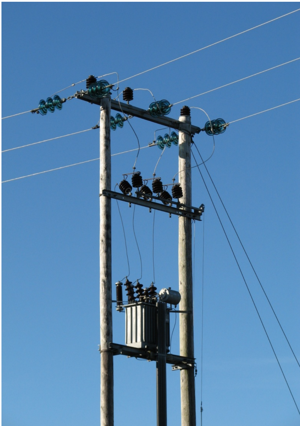
Figur 7. Stolpemontert transformatorer i tilknytning til distribusjonsnettet er blant de strukturer som oftest forårsaker elektrokusjonsulykker hos fugl pga. de korte avstandene mellom strømførende ledninger og/eller strømførende ledning og jordet del. Foto: Kjetil Bevanger.
